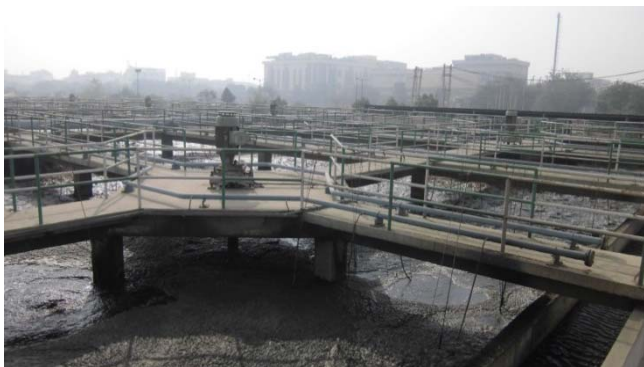
▲工業団地の排水処理施設。東芝子会社が運営しており、工業化に伴う環境汚染を防止しています。
